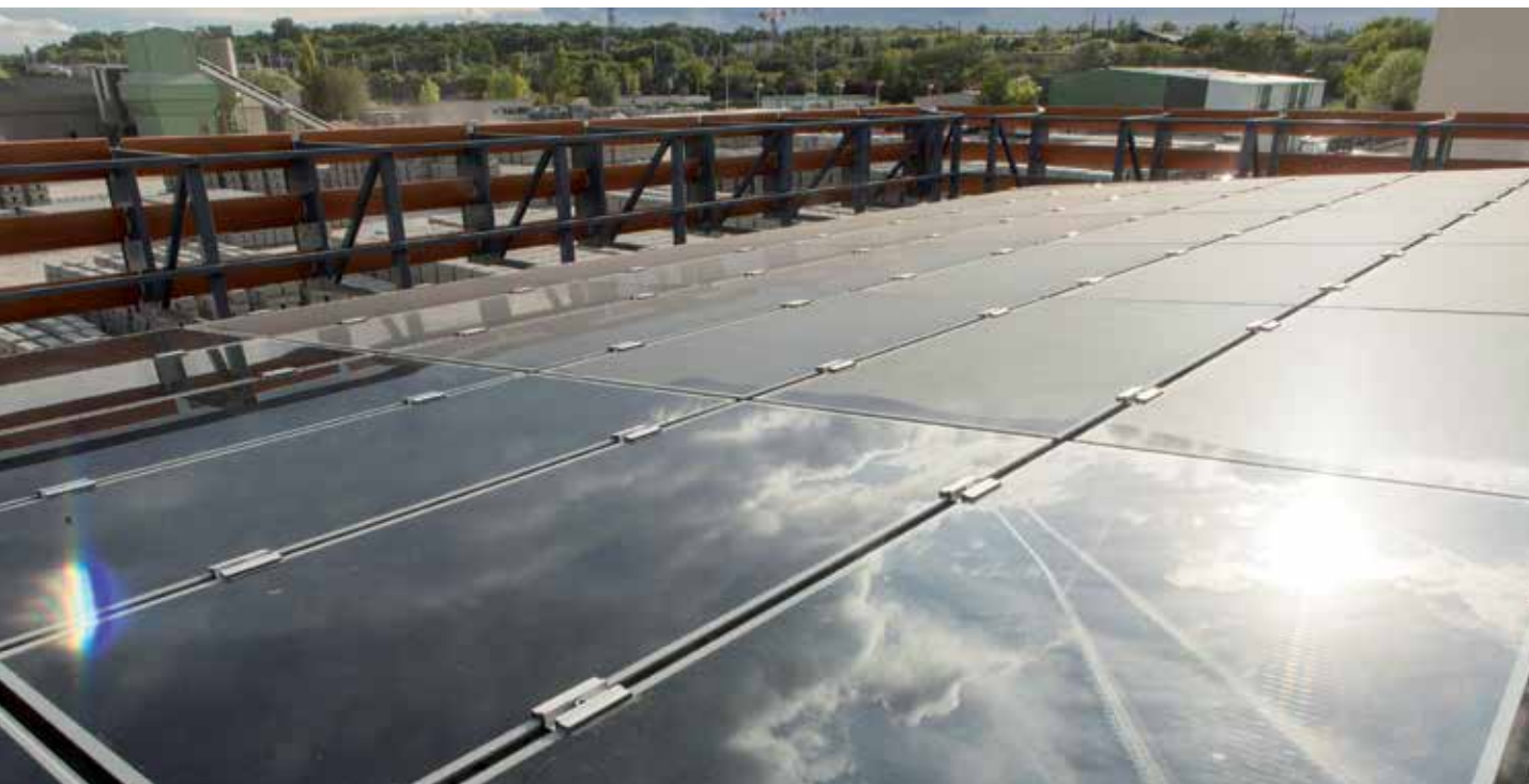
Fotovoltaické panely instalované na nízkoenergetickou budovu SDESM | Foto: ARENE Île-de-France, C. Bertolin
