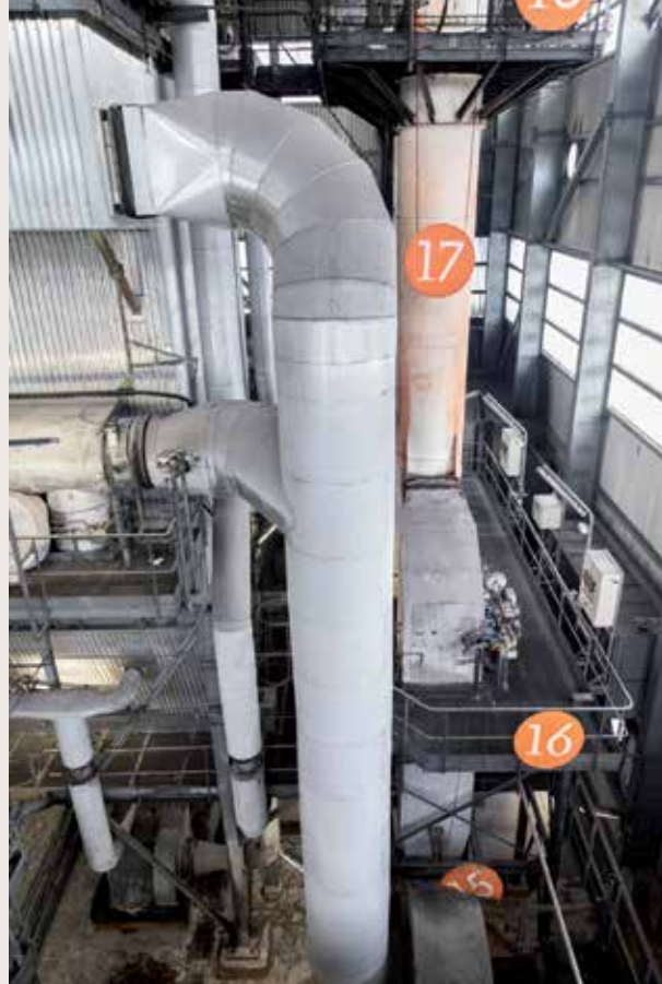
Jednotka čištění spalin ve spalovně Vaux-le-Penil Foto: ARENE Île-de-France, C. Bertolin
