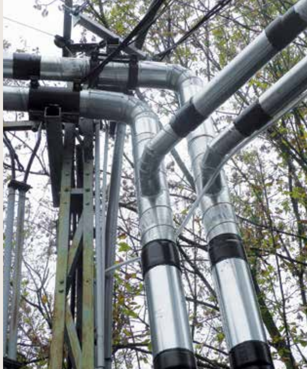
Teplovodní rozvody: předizolované potrubí s plechovým pláštěm | Foto: SEVEn
