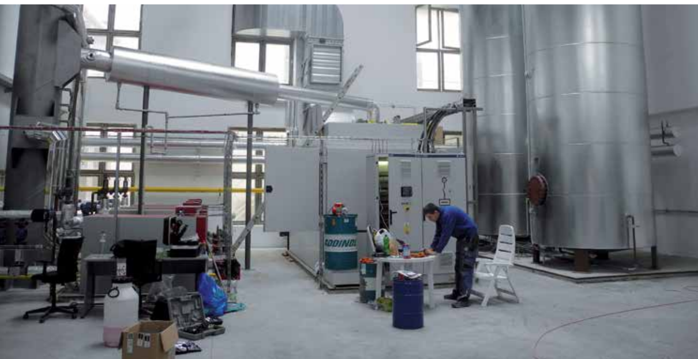
Nový zdroj tepla – Kogenerační jednotka, kotle a zásobníky tepla | Foto: SEVEN
