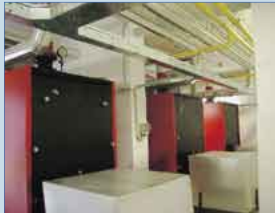
Plynové kotle v Lázních Aurora Boiler house Lázně Aurora
