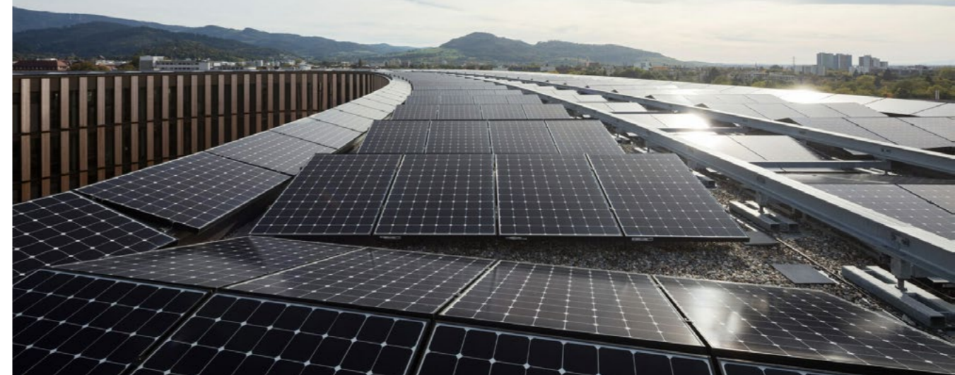
Fotovoltaické a fotovoltaicko-termické panely pokrývají 75 % povrchu střechy.
