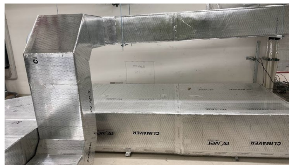
Umístění VZT potrubí v nejvyšším patře budovy bývalé banky v ulici Na Příkopech nebylo snadné, avšak díky vysoké flexibilitě systému CLIMAVER proveditelné.
