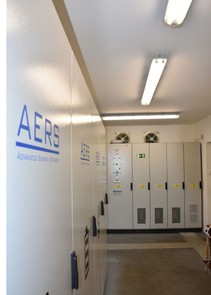
Velkokapacitní špičkovací stanice firmy AERS v interiéru.
