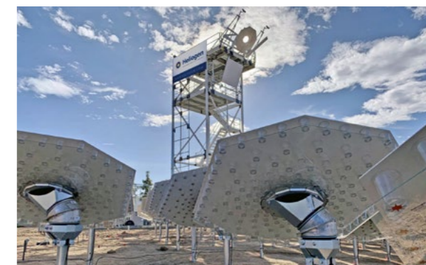
Heliostat je ukotvený na konstrukci z předpjatého betonu a ocelové trubce.
