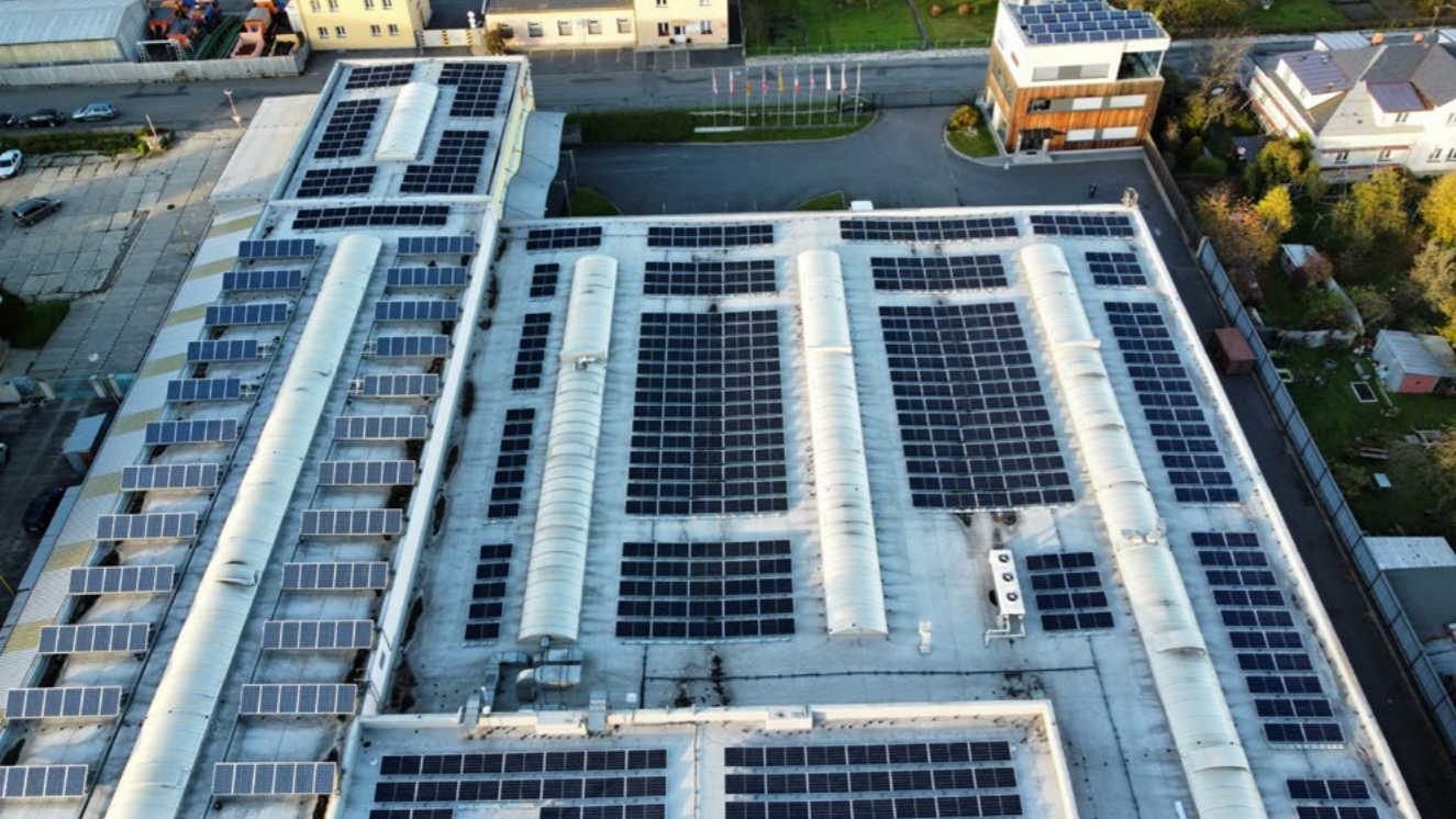
Fotovoltaická elektrárna na střeše výrobního závodu Fenix s.r.o. v Jeseníku.
